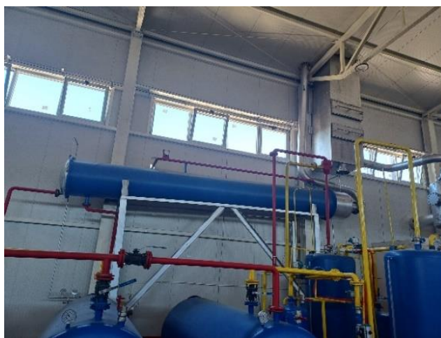
Slika 4. Dijelovi postrojenja (kondenzator, rezervoari za pirolitičko ulje, rezervari vode,)
