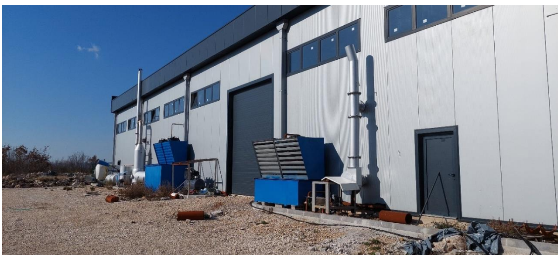
Slika 22. Odvodi dimnih gasova iz postrojenja za pirolizu i ulnog postrojenja
